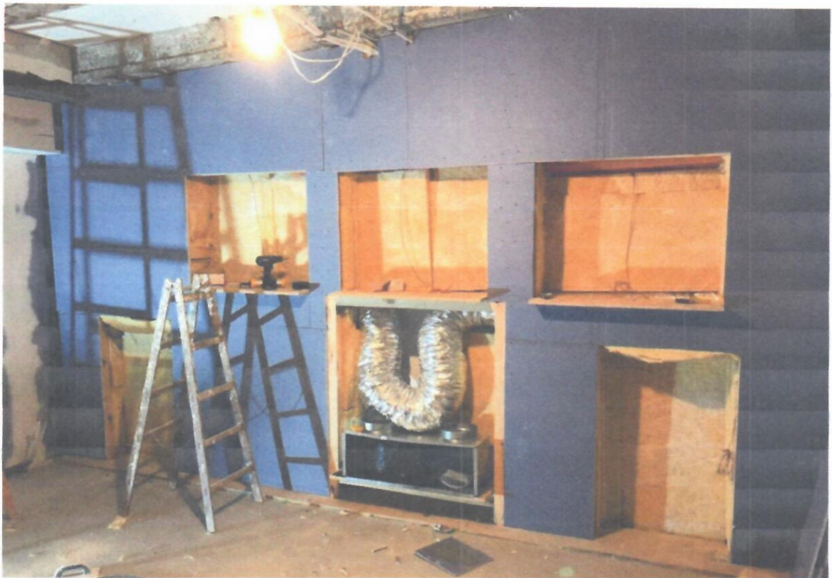
Rysunek 3 Baffle Wall z zainstalowaną płytą akustyczną
